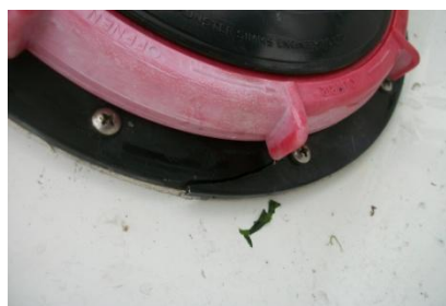
Watertight lid crack
